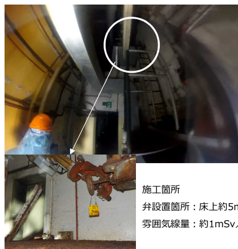
原子炉キャビティ差圧調整ライン状況
