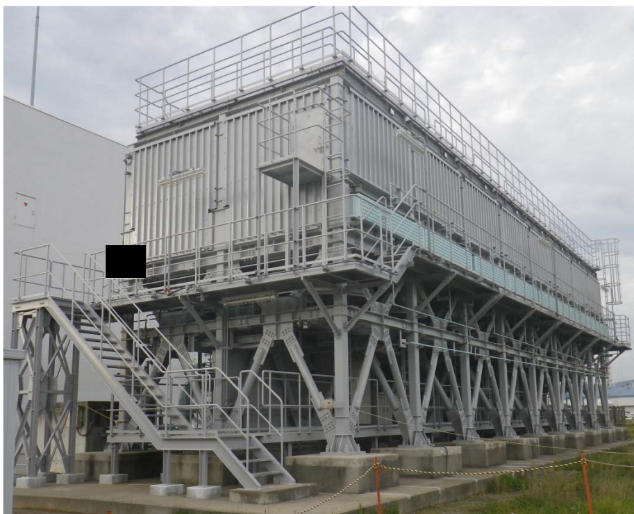
10. G 9 運転予備用冷却水設備：冷却塔 [REDACTED]
