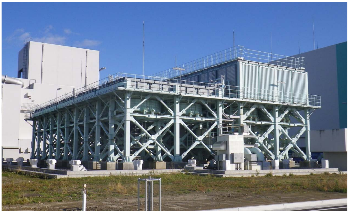
18. 冷却水設備：安全冷却水B冷却塔 [REDACTED]
