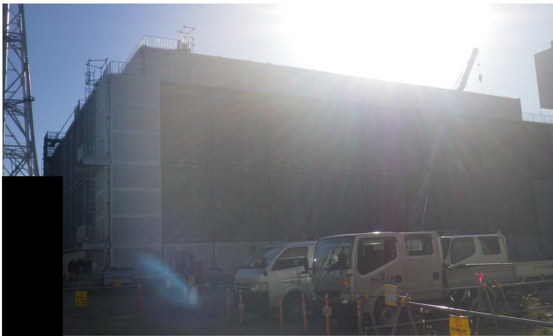
19. 使用済燃料受入れ・貯蔵施設用冷却水設備： 安全冷却水系冷却塔A／膨張槽A [REDACTED]
