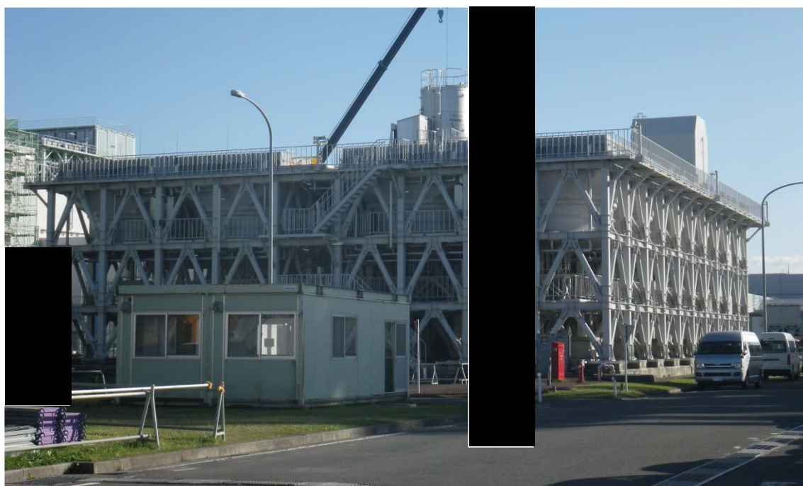
20. 使用済燃料受入れ・貯蔵施設用冷却水設備 安全冷却水系冷却塔A／膨張槽A [REDACTED]
