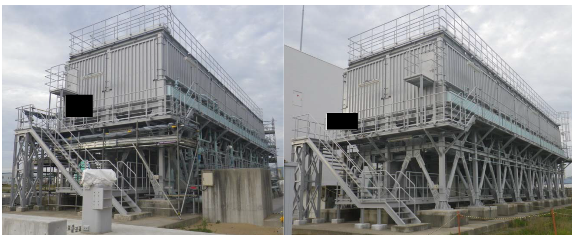
16. G10 非常用電源建屋 冷却水設備：
