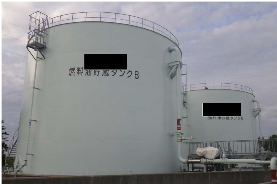
4. G 3 ボイラ用燃料受入れ・貯蔵所： 燃料油貯蔵タンク A / B
