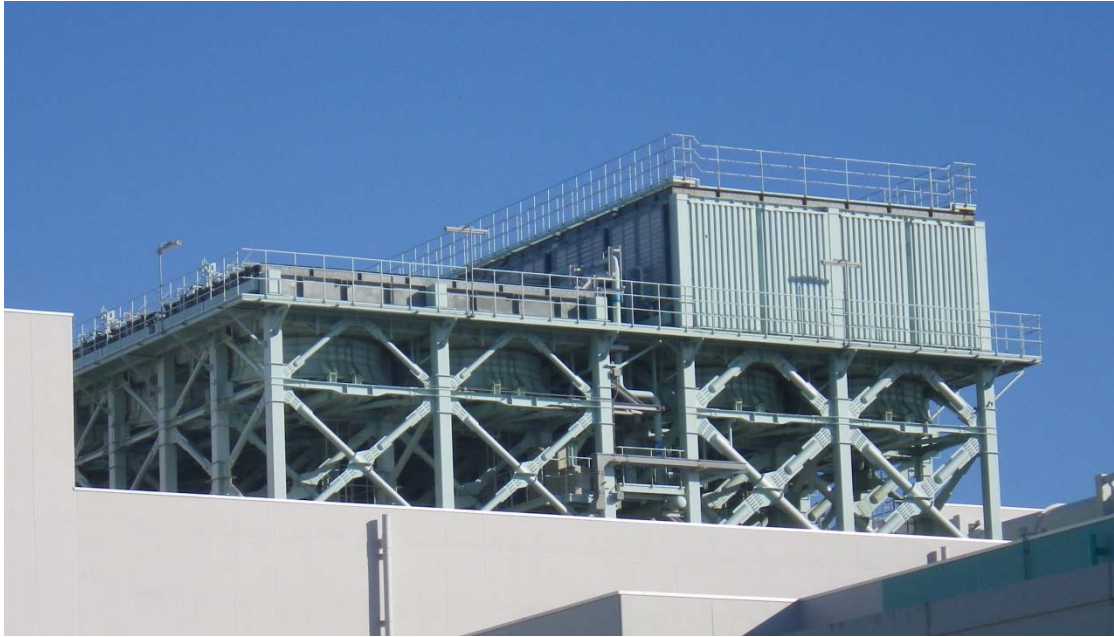
17. 冷却水設備：安全冷却水A冷却塔 [REDACTED]
