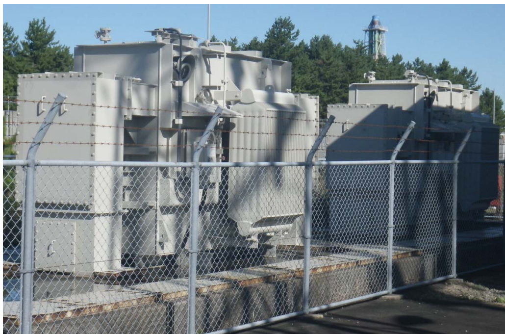
1. G 1 開閉所：構内電源設備現流リアクトルD 1 / D 2 [CLR-D1/D2]
