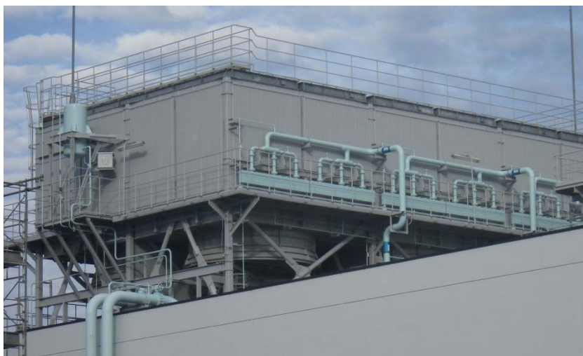
9. G 8 先行用冷却水設備：
