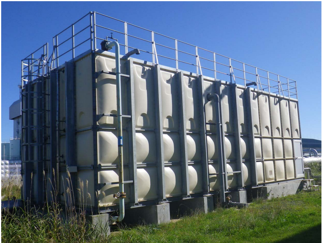
3. G 2 常用冷却水設備：散水用水貯槽
