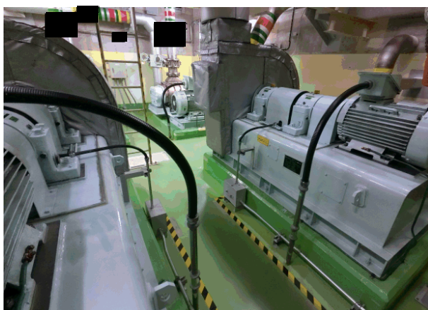
分離建屋 パルセータ廃ガス処理設備 排風機
