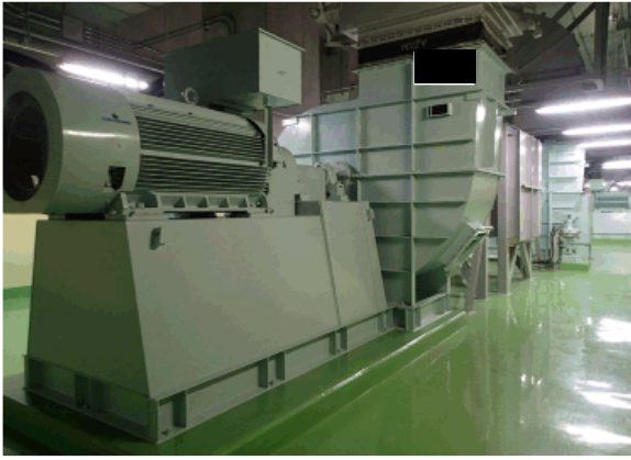
精製建屋換気設備 グローブボックス・セル排風機 (手前 A 系、奥 B 系)
