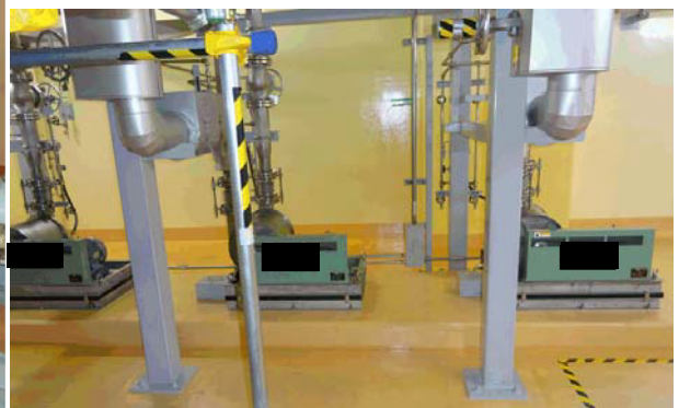
ウラン・プルトニウム混合脱硝建屋 塔槽類廃ガス処理設備 排風機
