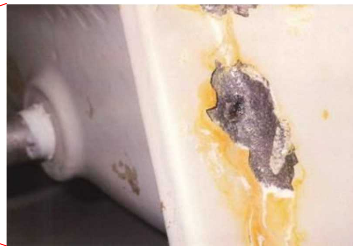
ピンホール発生箇所
