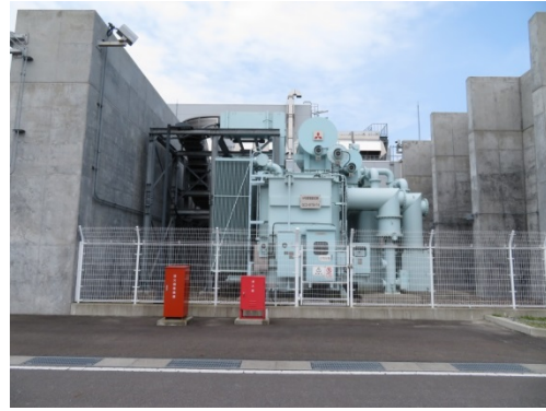
4号受電変圧器
