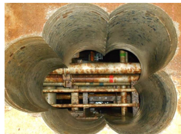
穿孔から見た地下階干渉物 (3号機R w / B床ドレンサンブA)
