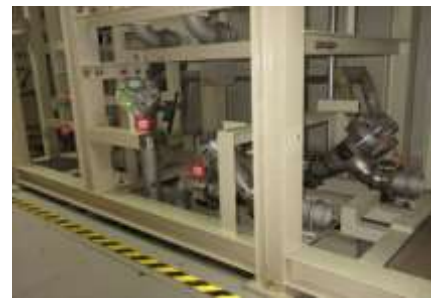
DOP-2カスケード設備 (配管)
