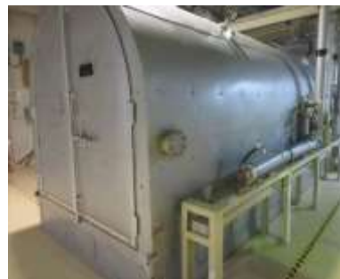
DOP-1UF 6 処理設備 (発生槽)
