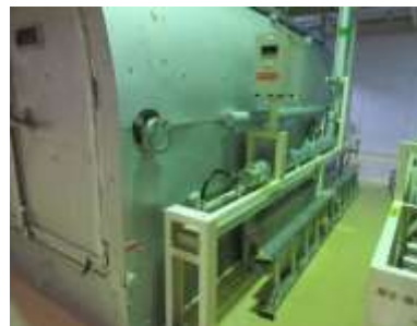
DOP-1UF 6 処理設備 (廃品回収槽)
