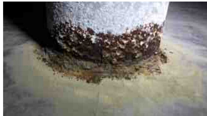
図4 保修が必要な腐食の例（位置決め部材で発生した全面腐食の例）
