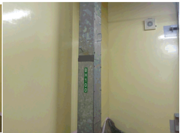
ウラン・プルトニウム混合酸化物貯蔵建屋 安全系ケーブルトレイ (B) (カメラ死角に A 系あり)
