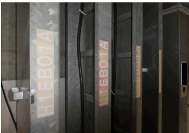
使用済み燃料受入れ・貯蔵施設用冷却 設備基礎(B) 安全系ケーブルトレイ (A) (B系は遠方にあり)
