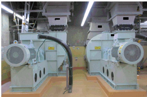
前処理建屋 溶解槽セル換気設備 排風機
