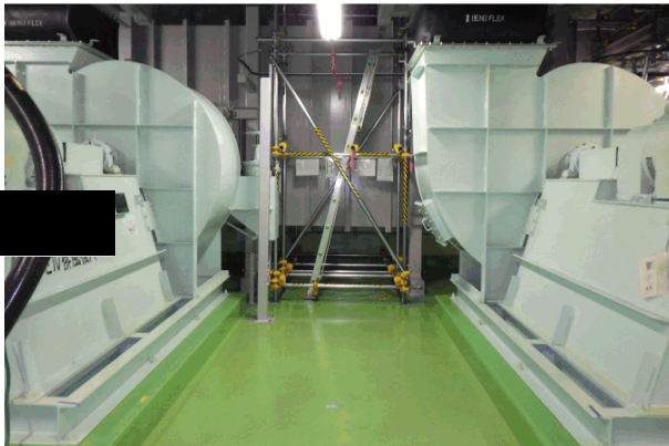
高レベル廃液ガラス固化建屋 換気設備 セル排風機
