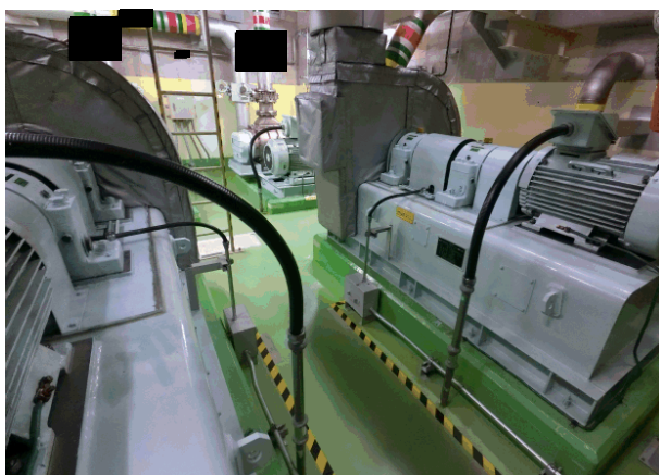
分離建屋 パルセータ廃ガス処理設備 排風機
