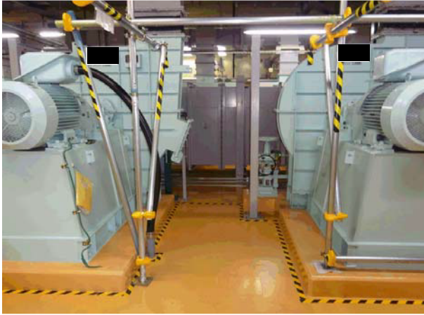
ウラン・プルトニウム混合脱硝建屋 グローブボックス・セル排風機
