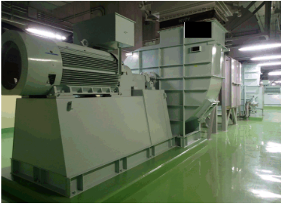
精製建屋換気設備 グローブボックス・セル排風機 (手前 A 系、奥 B 系)
