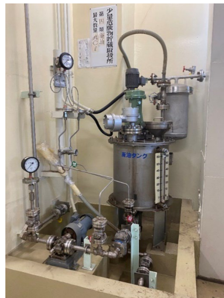
有機溶媒貯槽
