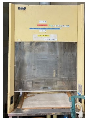
管理機械棟ホット実験室フード
