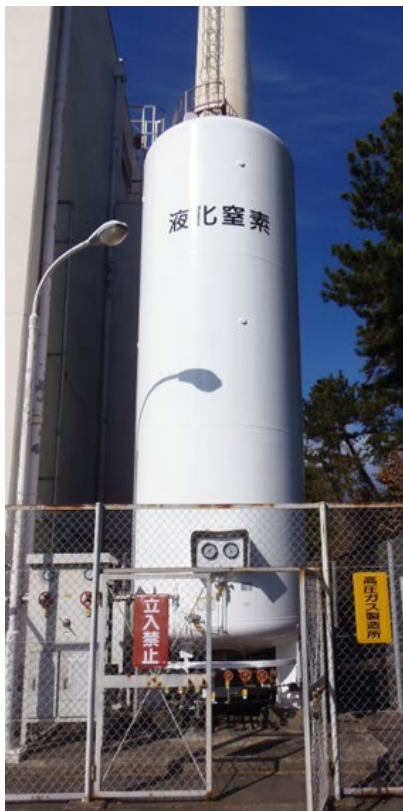
窒素ガス供給設備
