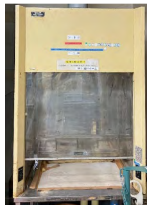
管理機械棟ホット実験室フード
