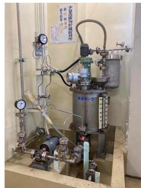
有機溶媒貯槽
