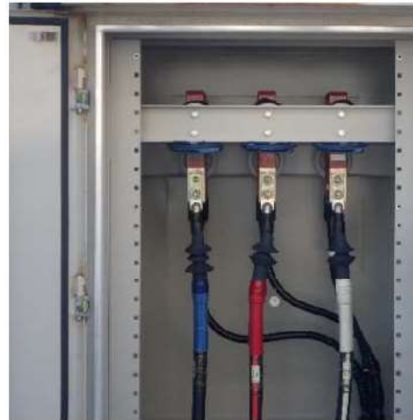
ボルト・ネジ接続 (代替交流電源)
