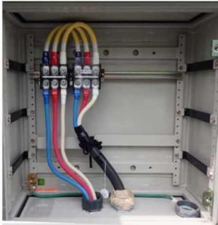
ボルト・ネジ接続 (代替直流電源)
