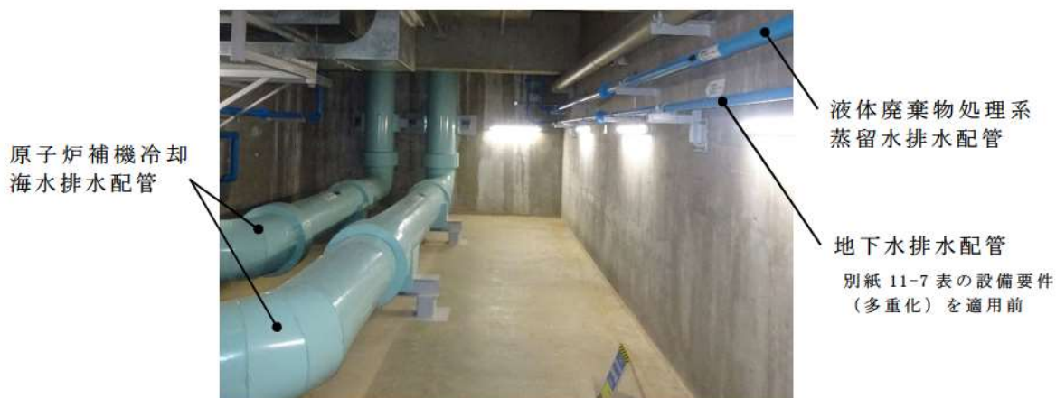
添付 7-6 図 地下水排水配管写真（電気建屋）
