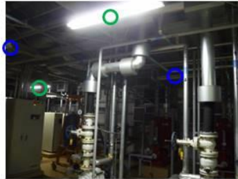
蓄電池内蔵の照明のみの点灯状態
