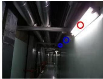
交流非常灯(保安灯)のみの点灯状態
