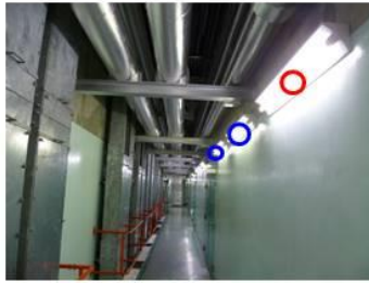
交流非常灯(保安灯)及び一般照明の点灯状態
