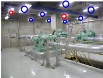
交流非常灯(保安灯)及び一般照明の点灯状態
