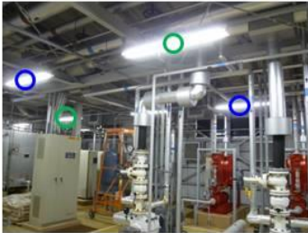
蓄電池内蔵の照明及び一般照明の点灯状態
