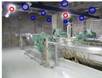
交流非常灯(保安灯)のみの点灯状態
