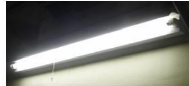
灯具に内蔵された蓄電池から給電される照明
