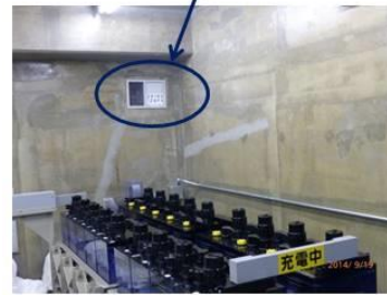
蓄電池室を換気している換気ダクト
