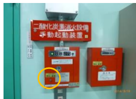
二酸化炭素消火設備を起動する場合には、封印を外してから起動操作を行う。
