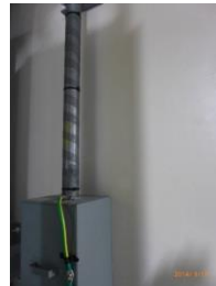
電線管内に納められている中性子計装ケーブル
