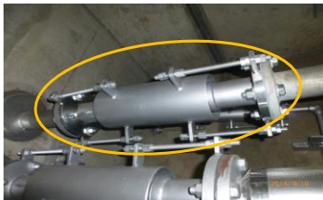
原子炉建家トレンチ間接続部のフレキシブル継手
