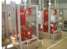
屋内消火栓ポンプ
