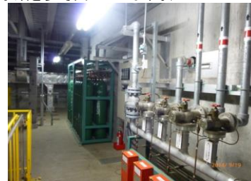
二酸化炭素消火設備
