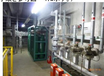
二酸化炭素消火設備
