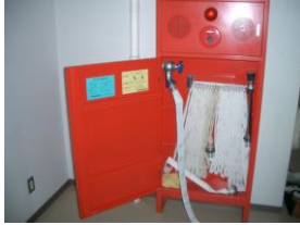
屋内消火栓ホース
