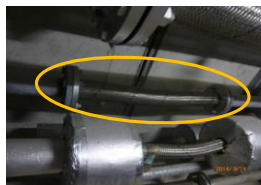
トレンチ内のフレキシブル配管
