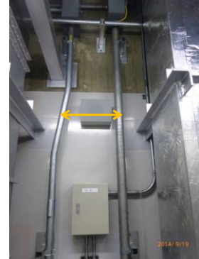
安全保護系計装ケーブルは電線管により分離
