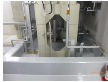
燃料油漏えい防止の為の堰
