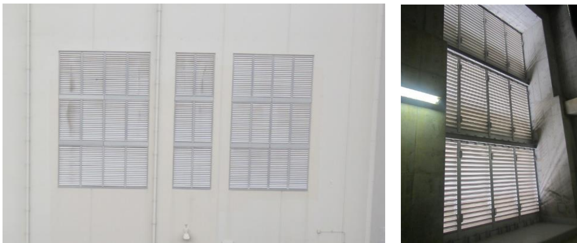
図3 原子炉建物のガラリ開口部の例
