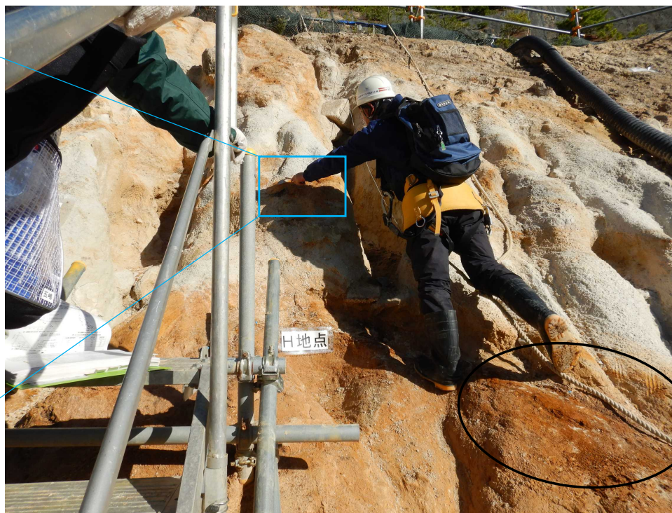
事業者が土壌化部と 評価している箇所
