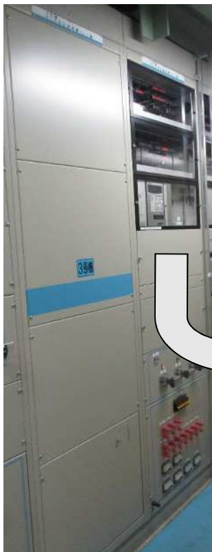
写真：主変圧器保護リレー盤 (高浜3号機を例)
