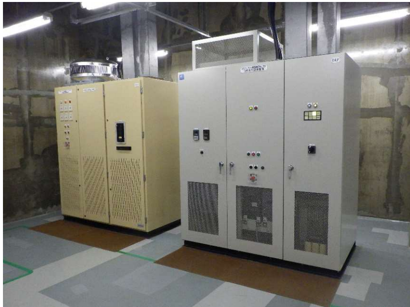
左:中間熱交換機用(1台)、右:2次加圧水冷却器用(1台)
