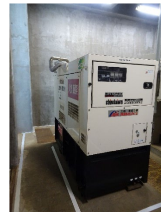
可搬型発電機
