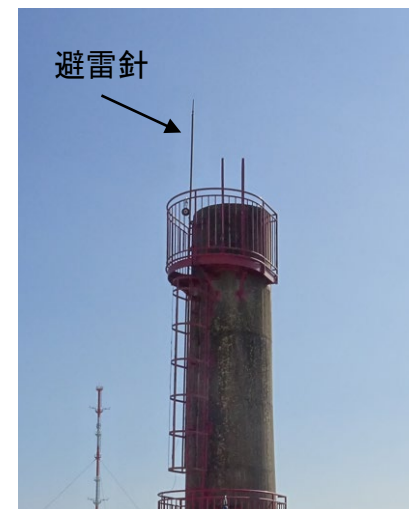
β・γ固体処理棟Ⅲ排気筒 避雷設備
