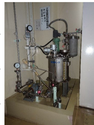
有機溶媒貯槽 (廃油タンク)
