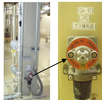
ガス漏れ検知器
