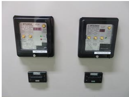
保護継電器等 (例) 減容処理棟(高圧盤)
