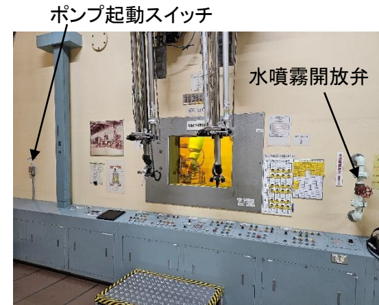
水噴霧消火設備
