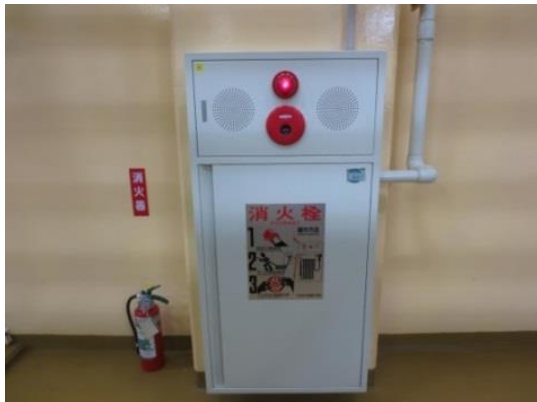
消火器及び消火栓
