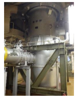
焼却処理設備
