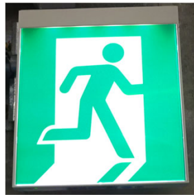
避難口誘導灯
