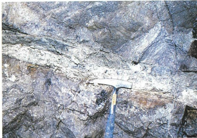
写真-1.14 白亜紀の花崗岩中の低角度断層に沿う熱水変質(低角度断層沿いに熱水変質を受けて白色の粘土鉱物を生じて軟弱化しているため、堤体の安定性に大きな影響を与える)
