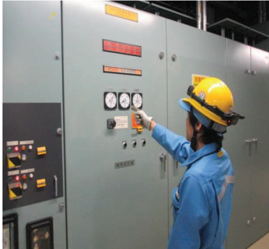
125V 代替充電器の受電状態確認
