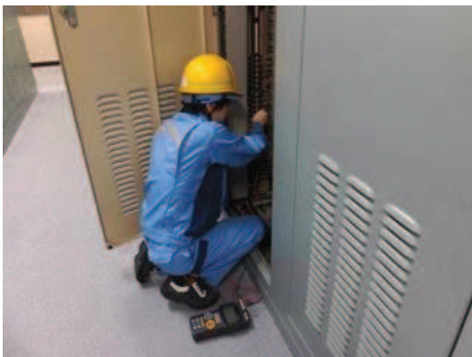
可搬型計測器接続
