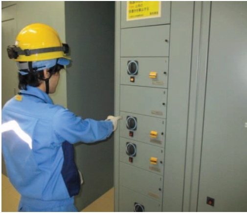
MCC 負荷の切離し操作
