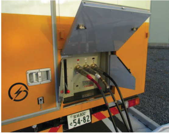
電源車ケーブル接続
