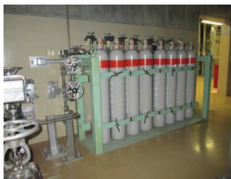
高圧窒素ガスポンペ
