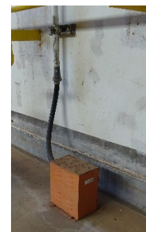
ガス漏れ検知器
