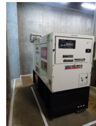
可搬型発電機
