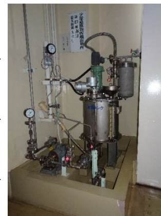
有機溶媒貯槽 (廃油タンク)
