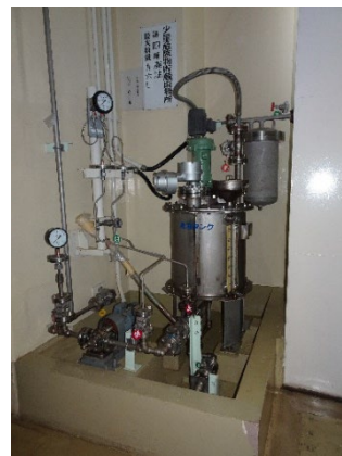
有機溶媒貯槽 (廃油タンク)
