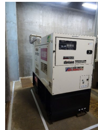
非常用発電機
