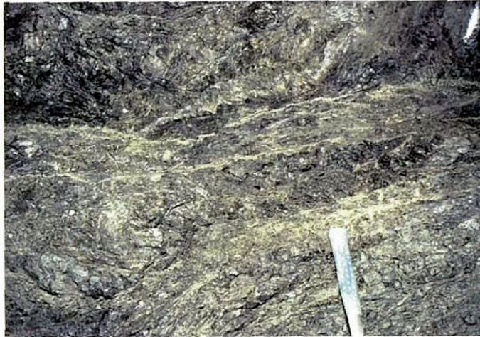
写真-1.5 中・古生代の緑色岩中のシーム(節理や小規模な断層沿いに熱水変質を受けて、幅 1cm 程度以下の多数の粘土化した脆弱なシームが複雑に発達して擾乱帯の様相を呈する)
