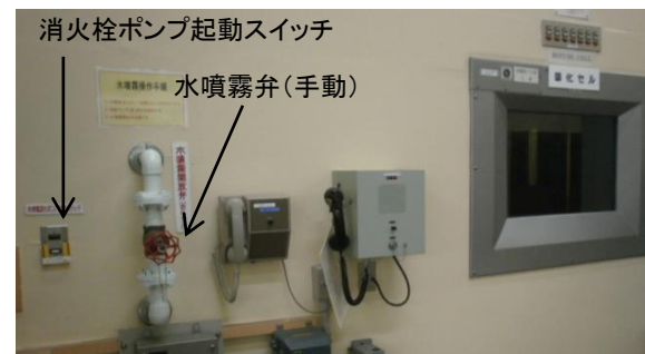
水噴霧消火設備
