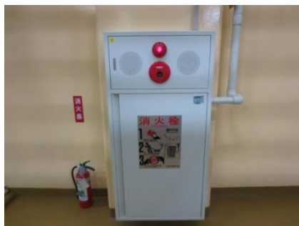
消火器及び消火栓
