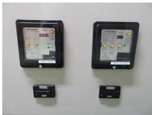
保護継電器等 (例) 減容処理棟(高圧盤)
