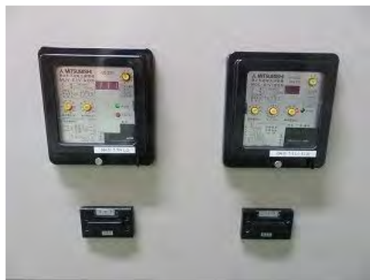
保護継電器等 (例) 減容処理棟(高圧盤)
