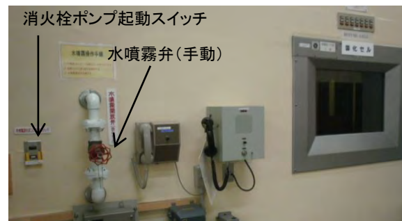
水噴霧消火設備
