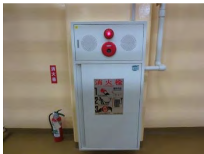
消火器及び消火栓
