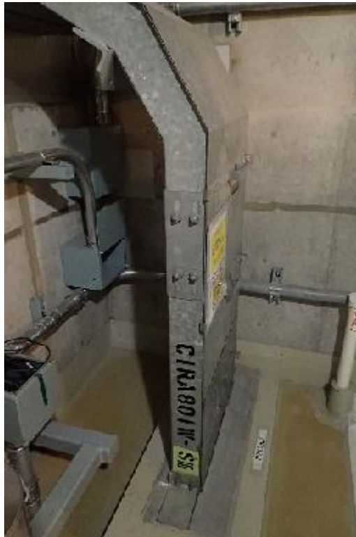
図 2-1 ケーブルトレイ床貫通部外観
