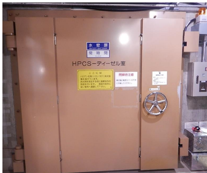
図2 水密扉設置状況
