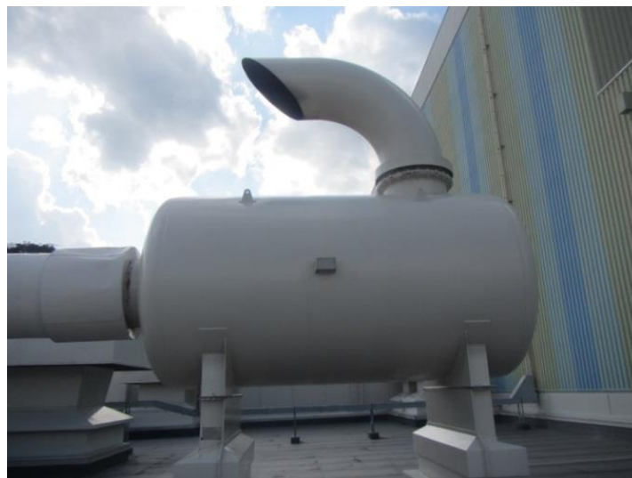
図 6.1.2-8 非常用ディーゼル発電設備ディーゼル機関排気消音器及び排気管
