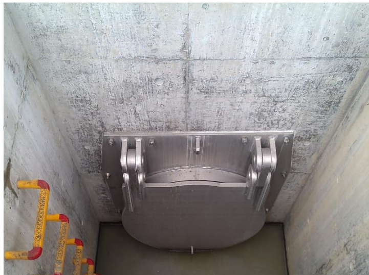
(屋外排水路逆止弁⑩の設置状況)
