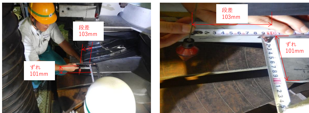
ずれ量・段差量確認
