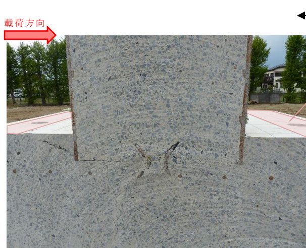
図 2.3.2-5 杭頭内部のひび割れ状況
