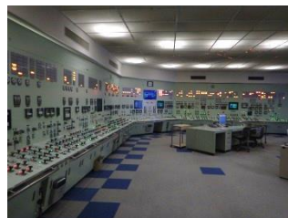
直流非常灯点灯時
