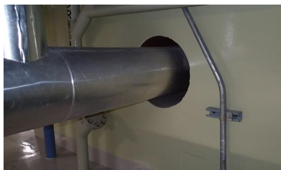
図 2 貫通孔の隙間例
