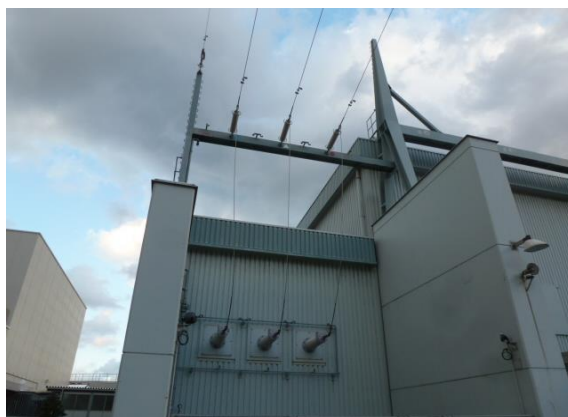
(66kV 開閉所 送電線引込部)
