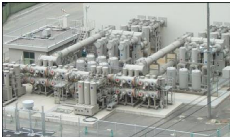
図 3-8 220kV 開閉所の外観
