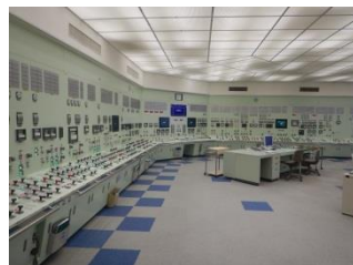
非常用照明点灯時
