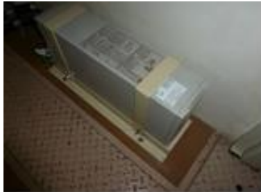
(モニタリングポスト用無停電電源装置の写真)
