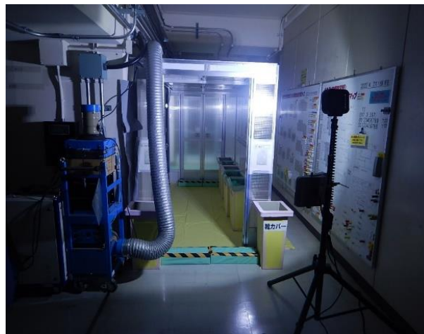
図 1.1-10 チェンジングエリア用照明確認状況
