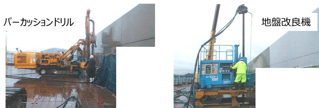
図 2-4 高圧噴射攪拌工法によるケーソン中詰材改良の施工状況
