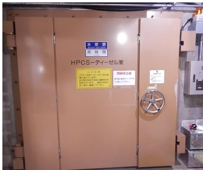
図2 水密扉設置状況
