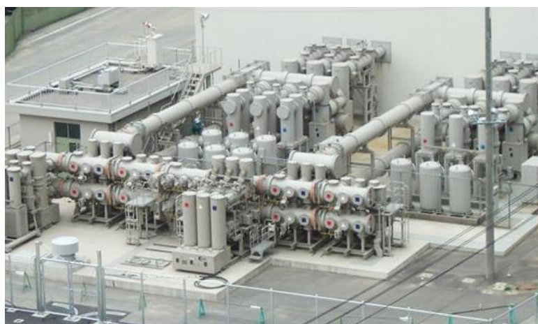
図 3-8 220kV 開閉所の外観
