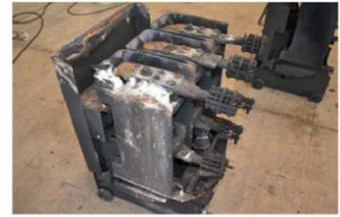
遮断器室アーク発生、アーク火災有、消火後の遮断器の様子
