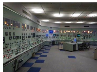
直流非常灯点灯時
