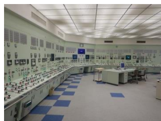
非常用照明点灯時
