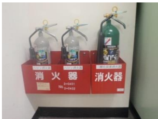
消火器設置状況
