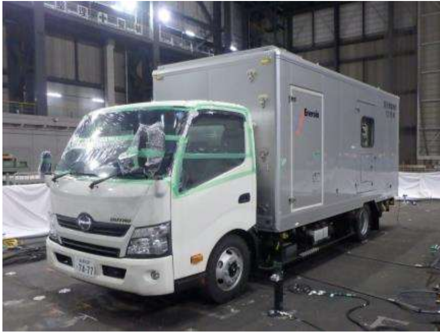
図 3-5 試験構成 (高圧発電機車 (タイプ II)) (5/10)
