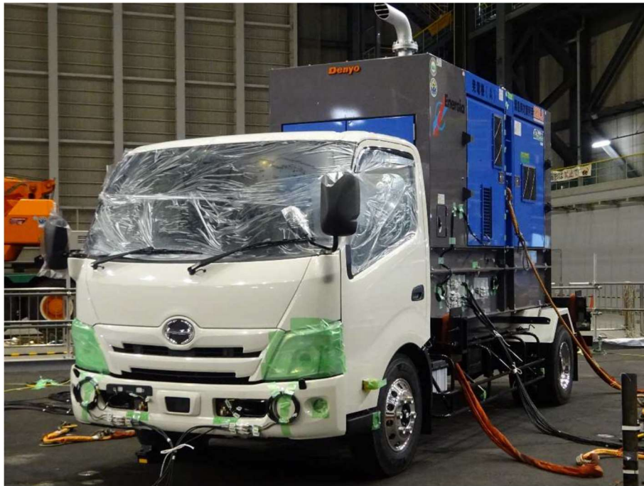
図 3-5 試験構成（緊急時対策所用発電機）（9/10）
