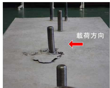
(参考) コンクリートのひび割れ状況
