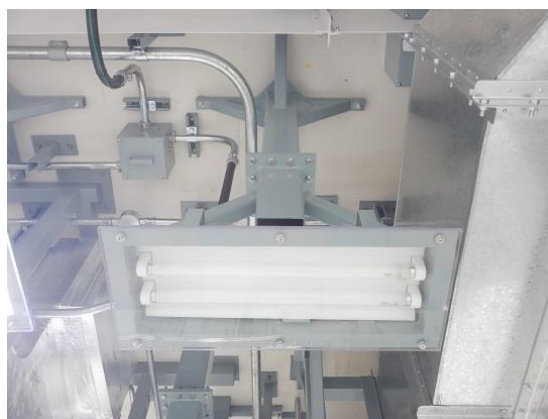
(写真は直流非常灯)
