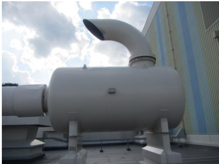
図 6.1.2-8 非常用ディーゼル発電設備ディーゼル機関排気消音器及び排気管
